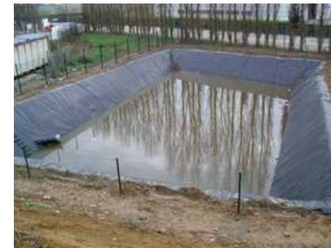
Bassin de rétention étanche en zone d'activité
