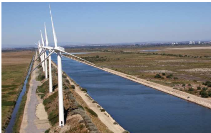
Parc éolien de Port Saint Louis du Rhône construit sur le territoire du Port Autonome le long de la berge du canal de navigation du Rhône au port de Fos-sur-Mer.
